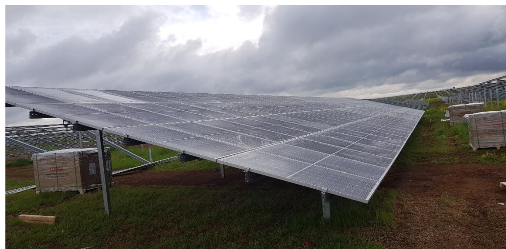
Figure 209 : Exemple d'installation de modules sur le site de Bienvenida (ESP) (source : ibvogt)
